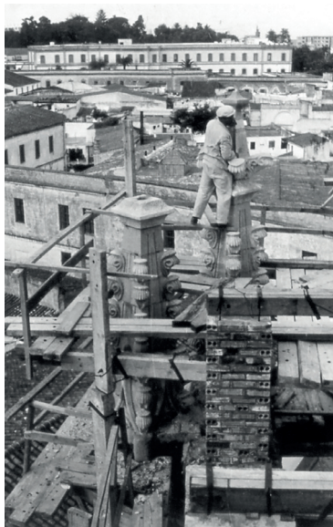
Figura 09. Pináculos pareados de los pies de la iglesia de Santiago durante las obras. 1963. (Archivo General de la Administración. Obras Públicas. Ministerio de la vivienda. Expediente de Restauración de la Parroquia de Santiago de Jerez de la Frontera).
